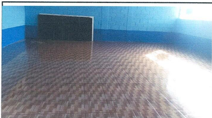
Foto 3: ESTADO ACTUAL DEL PISO CERAMICO Y PINTURA AULA NÚMERO 1
